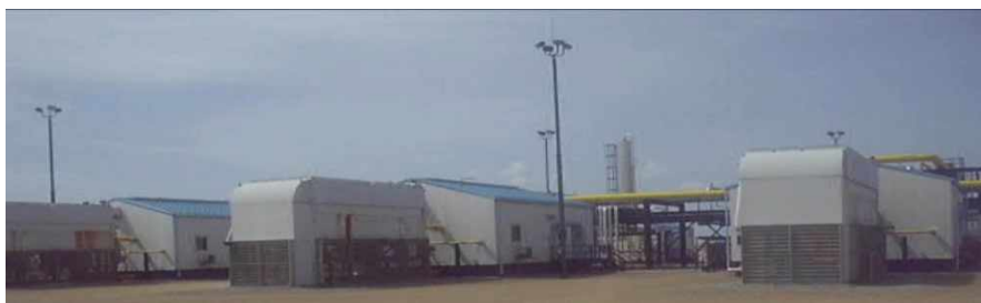
Рис-1. Газокомпрессорные агрегаты ГТЭС Кумколь
